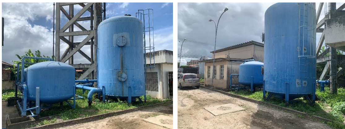
Vistas gerais do floculador e filtros pressurizados
