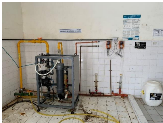
Sistema de geração de dióxido de cloro
