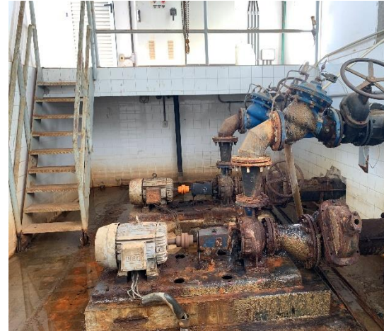
Vista interna da estação elevatória
