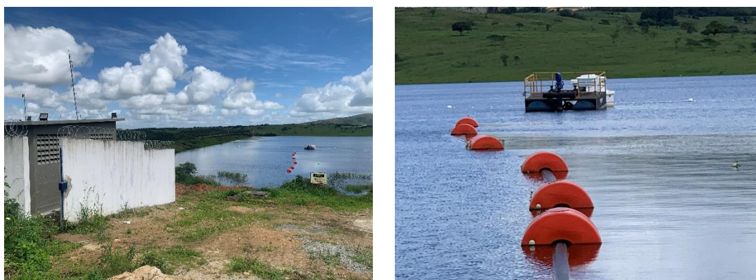
Estação Elevatória de Água Tratada da Cajaíba
