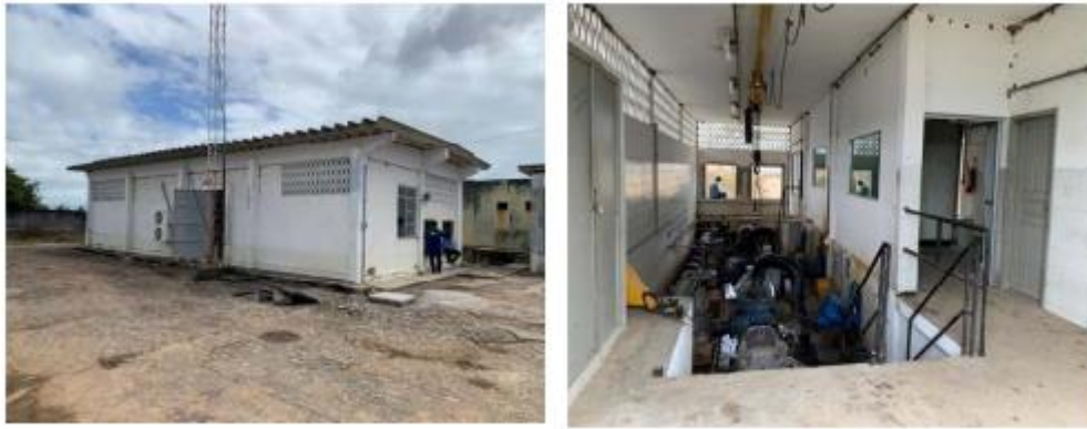
Vistas externas e internas da estação elevatória e externa
