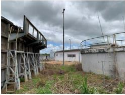
Reservatório de água de lavagem
