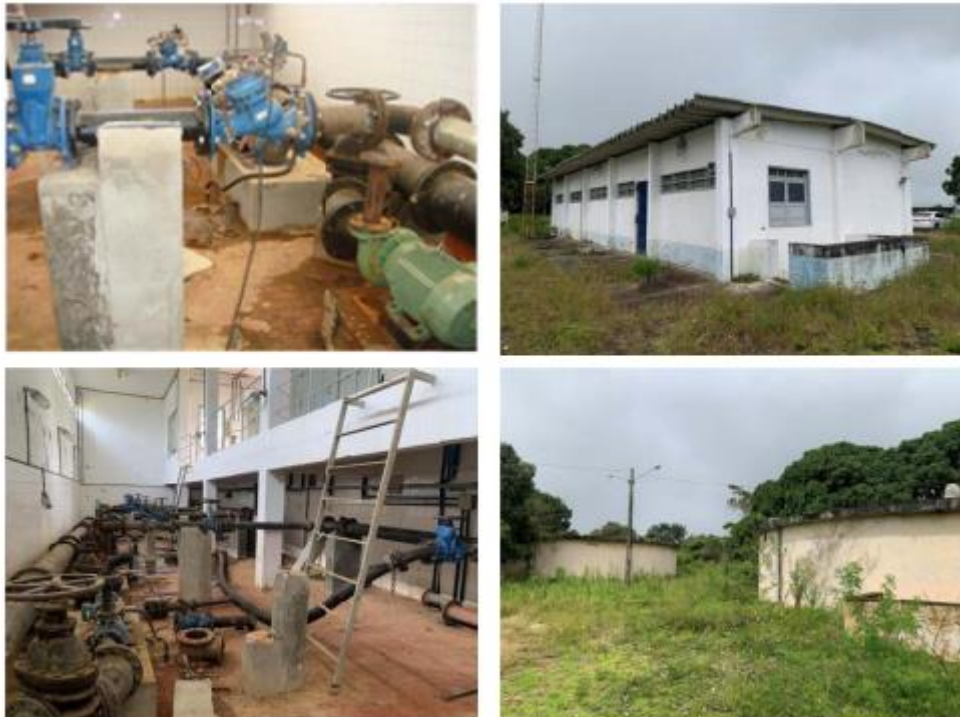
Vistas gerais da Área 800 e interna da estação elevatória EE-7
