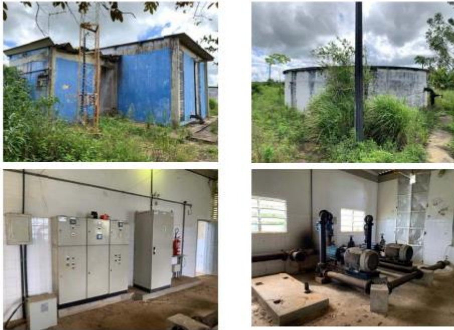
Vistas externas da Área 2000 e interna da Estação Elevatória EE-12
