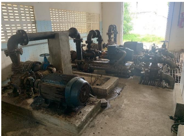
Vista geral dos conjuntos elevatórios
