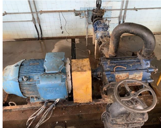
Detalhe de um conjunto elevatório
