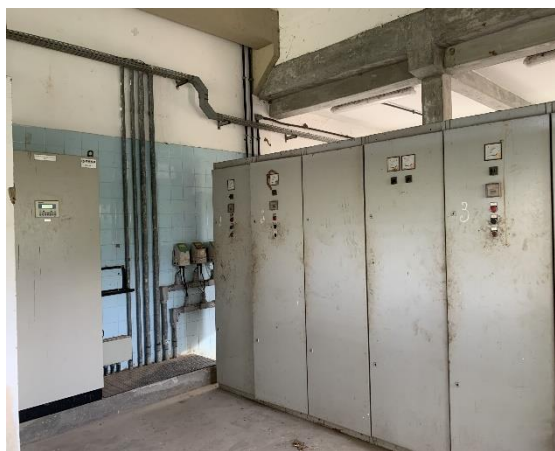
Vista dos quadros de comando dos conjuntos
