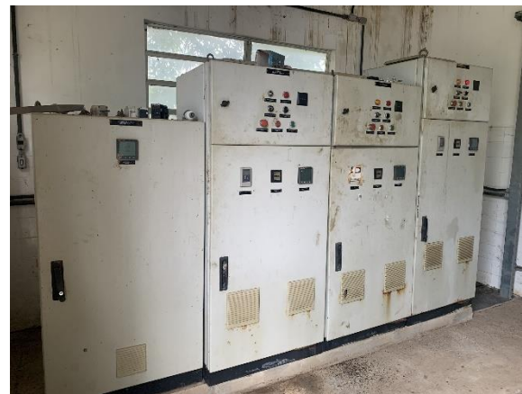
Vista dos quadros de comando dos conjuntos elevatórios
