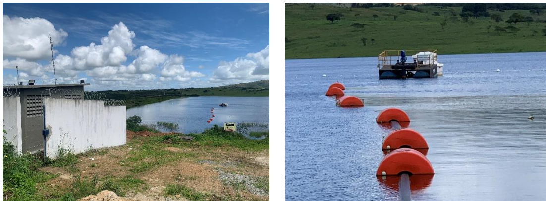
Vista geral da casa dos quadros de comando e da captação flutuante da Cajaíba
