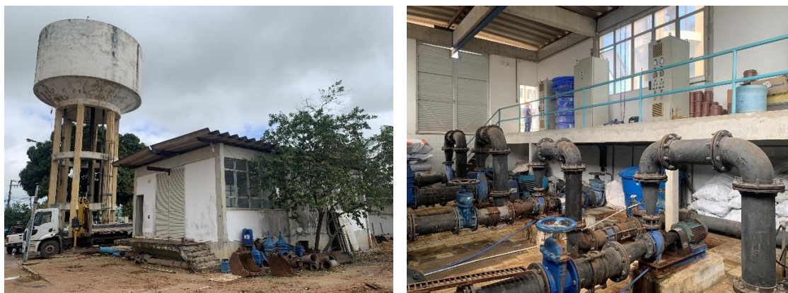
Vistas externa e interna da estação elevatória de água tratada de Itabaiana
