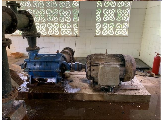
Vistas dos conjuntos elevatórios
