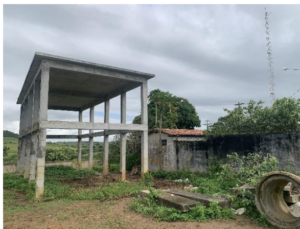
Subestação do Booster B3
