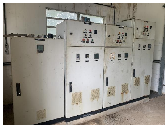
Vista dos quadros de comando dos conjuntos elevatórios
