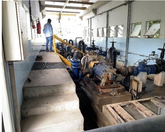
Vista geral interna da estação elevatória EE-1
