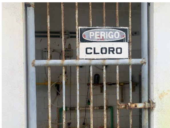
Vista externa do posto de cloração
