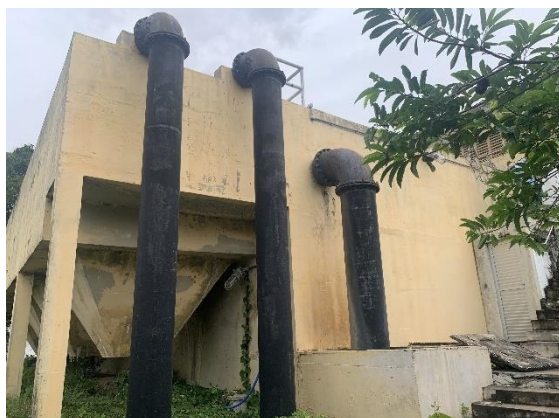
Vista da caixa de areia e poço de sucção
