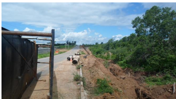
Adutora principal de 600 mm de diâmetro
