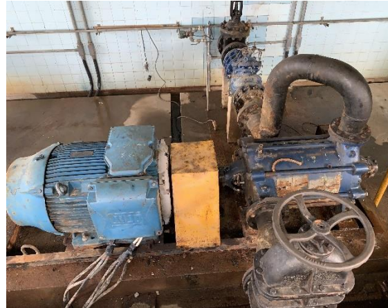
Detalhe de um conjunto elevatório
