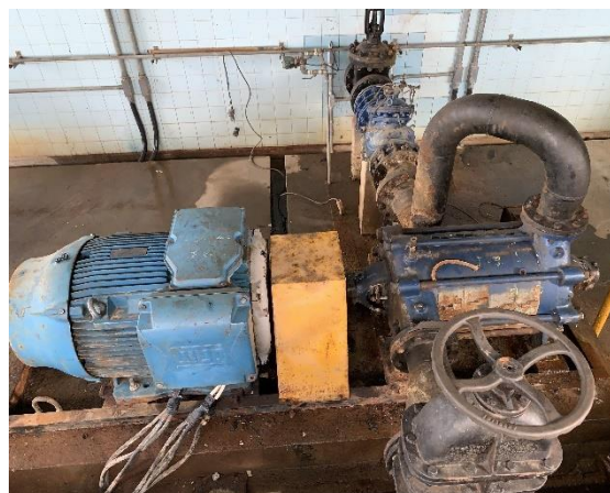
Detalhe de um conjunto elevatório
