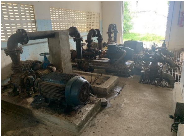
Vista geral dos conjuntos elevatórios
