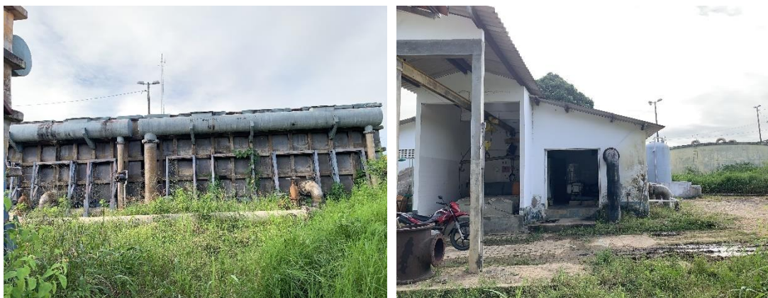
Vista geral da ETA, reservatório de água tratada e Casa de Química
