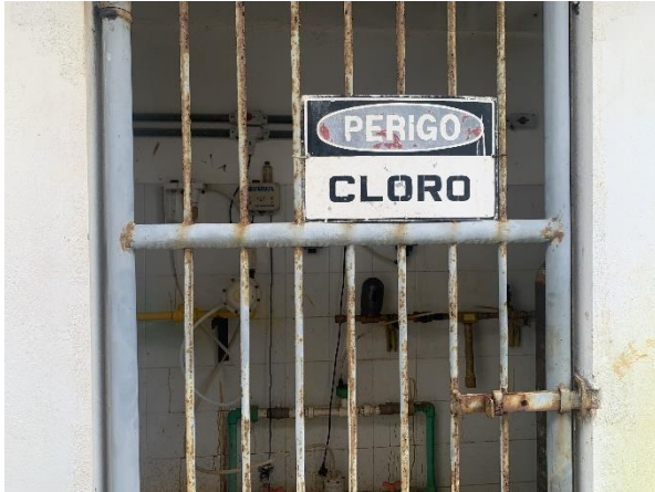
Vista externa do posto de cloração
