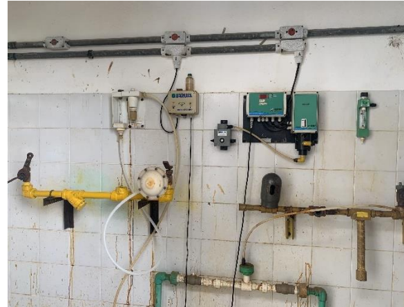
Vista geral dos equipamentos de cloração
