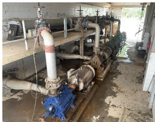
Vista interna da elevatória EEO
