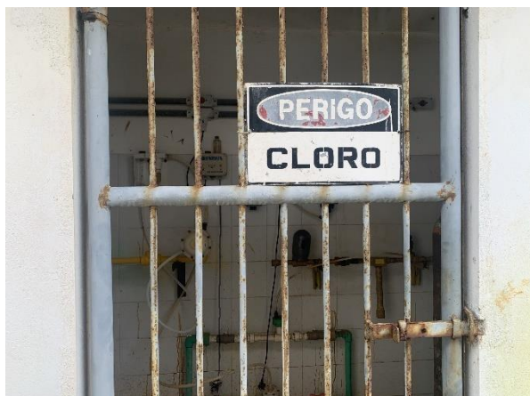
Vista externa do posto de cloração
