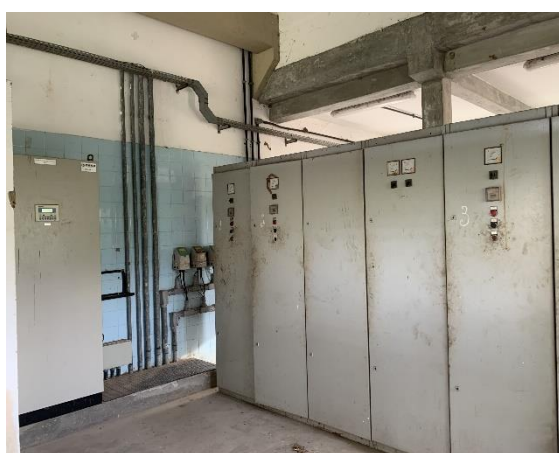
Vista dos quadros de comando dos conjuntos
