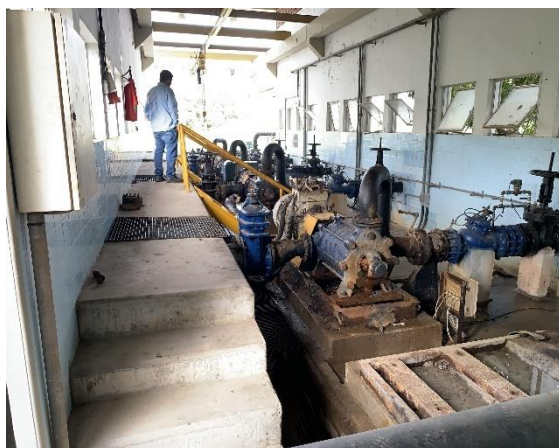
Vista geral interna da estação elevatória EE-1
