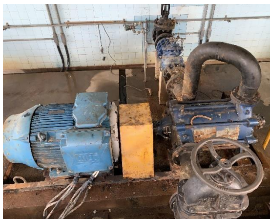
Detalhe de um conjunto elevatório
