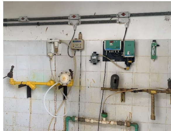
Vista geral dos equipamentos de cloração
