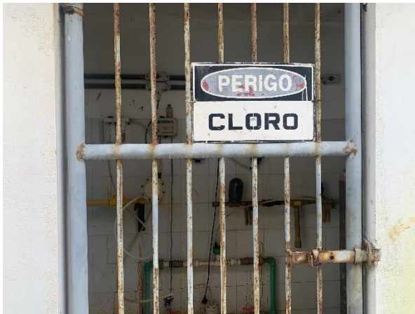
Vista externa do posto de cloração
