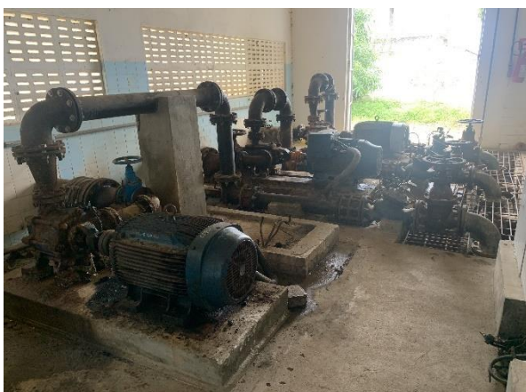
Vista geral dos conjuntos elevatórios
