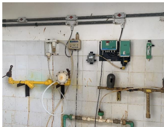
Vista geral dos equipamentos de cloração
