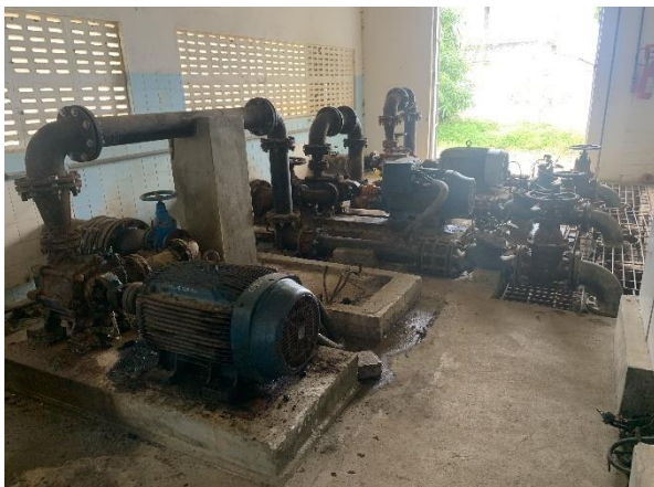
Vista geral dos conjuntos elevatórios
