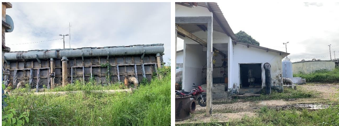
Vista geral da ETA, reservatório de água tratada e Casa de Química
