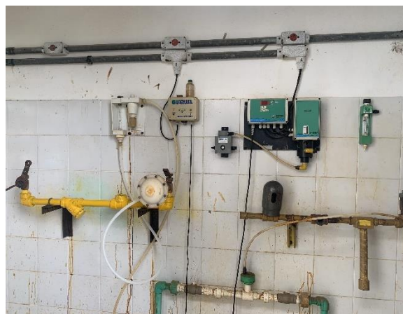
Vista geral dos equipamentos de cloração
