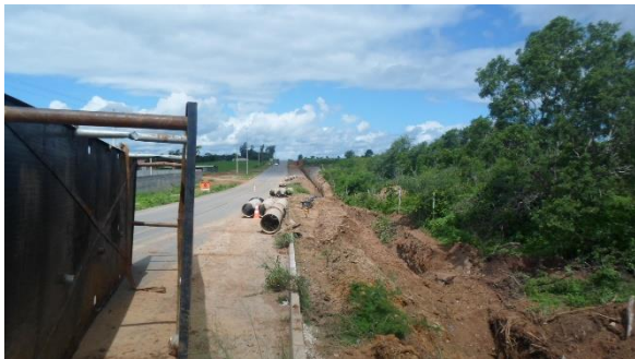
Adutora principal de 600 mm de diâmetro
