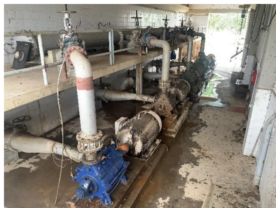
Vista interna da elevatória EEO
