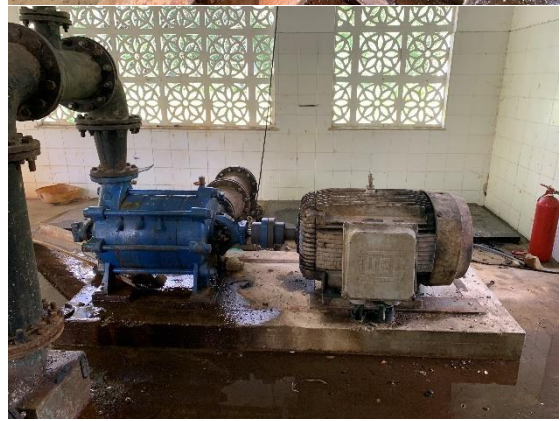
Vistas dos conjuntos elevatórios
