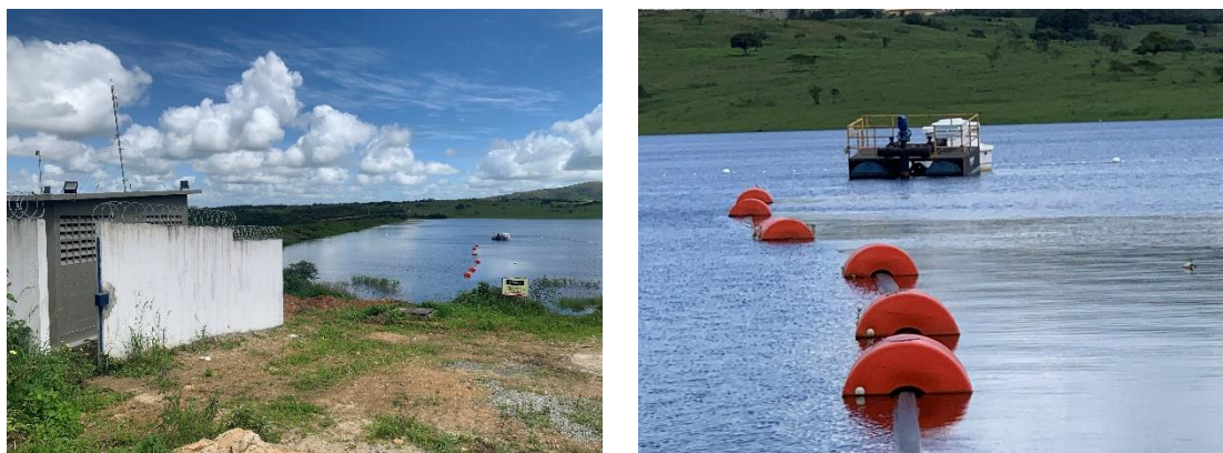
Vista geral da casa dos quadros de comando e da captação flutuante da Cajaíba
