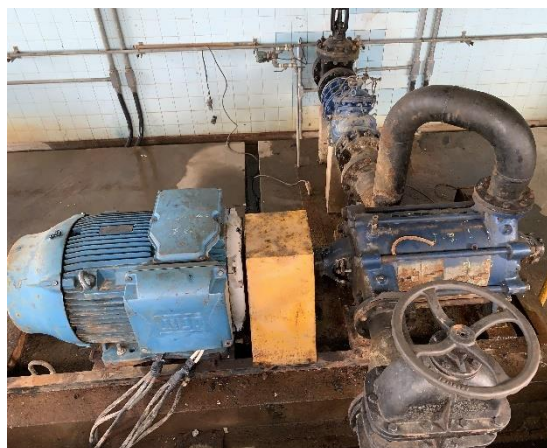
Detalhe de um conjunto elevatório
