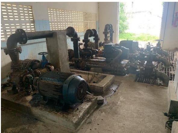
Vista geral dos conjuntos elevatórios
