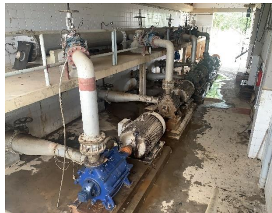
Vista interna da elevatória EE0
