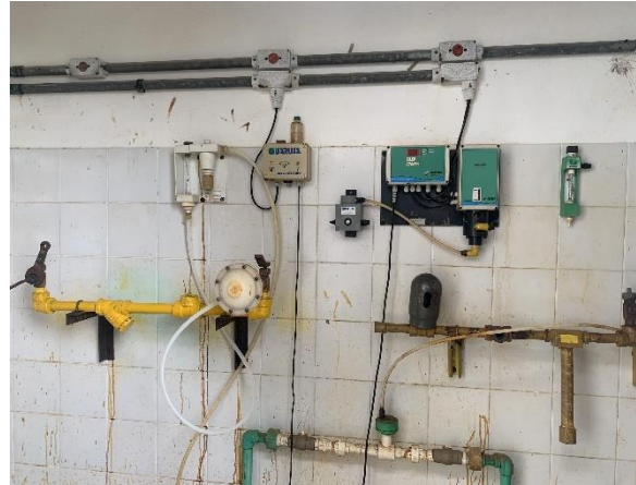
Vista geral dos equipamentos de cloração
