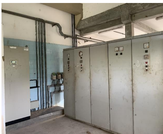
Vista dos quadros de comando dos conjuntos
