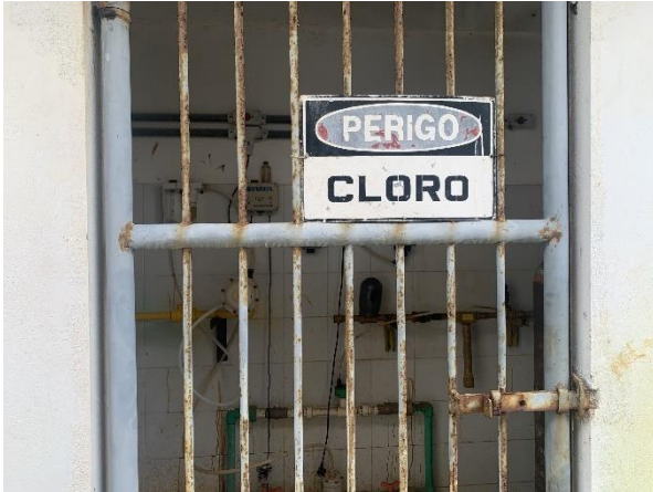
Vista externa do posto de cloração
