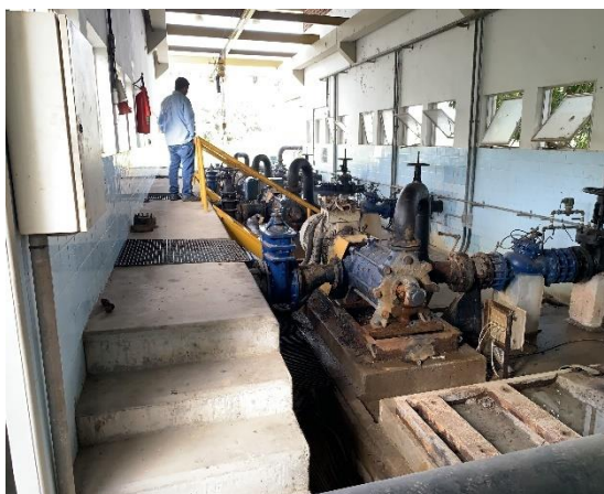
Vista geral interna da estação elevatória EE-1
